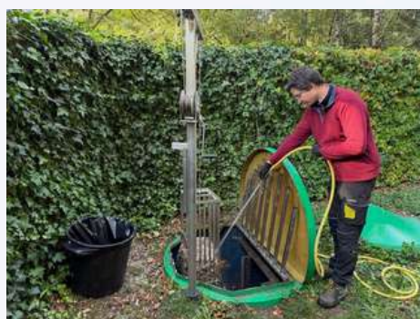
Emmanuel nettoie le dégrilleur de Saint-Barthélemy.
