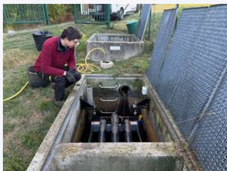
Emmanuel inspecte le répartiteur de Grozon.
